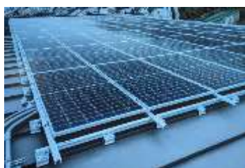
既設太陽光パネル
