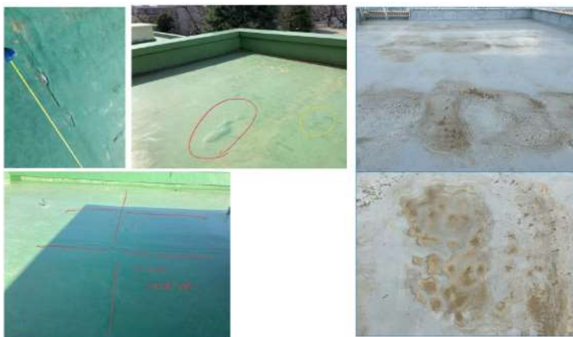
図 8-1-3 防水の損傷個所例
