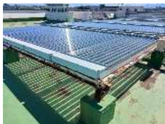
既設太陽熱パネル
