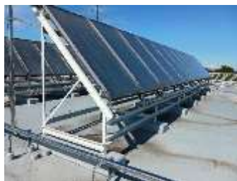
既設太陽熱パネル
