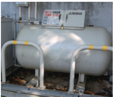
▲災害対応型のプロパンガス設備
