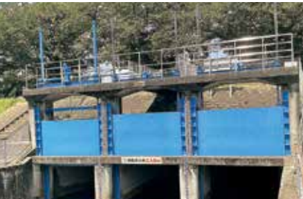
▼是政排水樋管(上)と矢崎都市下水路吐口(下)
