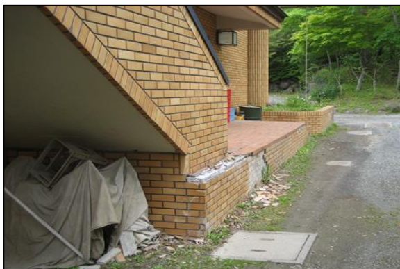
宿泊棟の外壁 タイルの剥がれ
