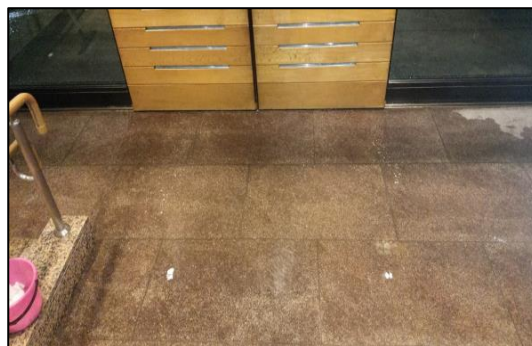
玄関部 隆起による玄関の浸水
