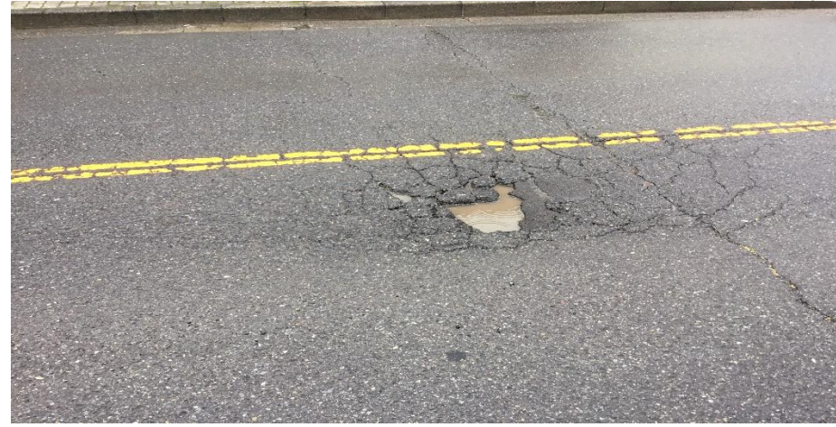
舗装の不具合
