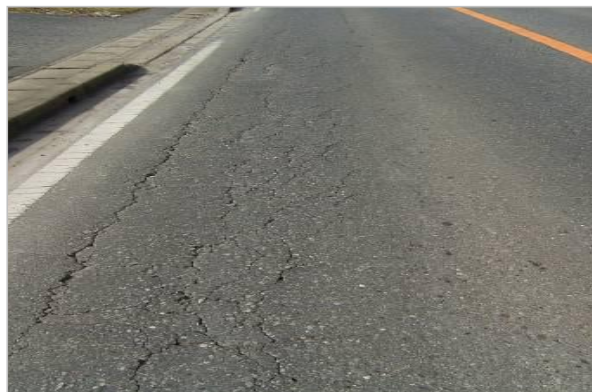
図 3-2-3-5 MCI=3.5~4 ひび割れが複数ある程度
