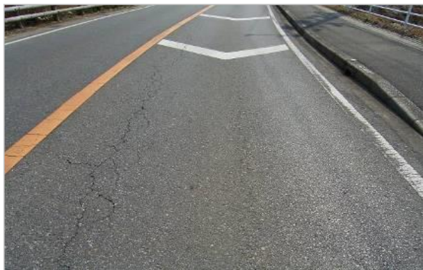
図 3-2-3-4 MCI=5 ひび割れが見える程度
