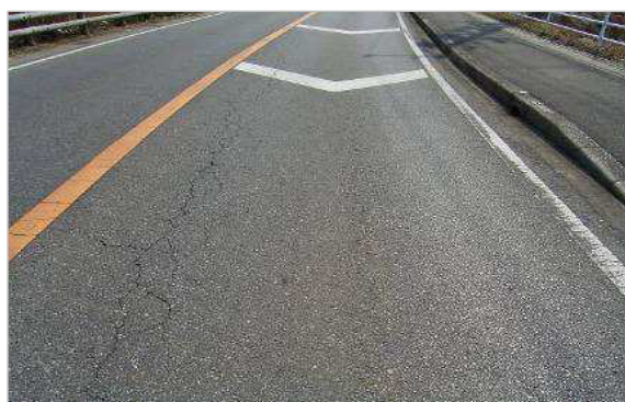
図 5-1-1-1 MCI 値=5 ひび割れが見える程度でオーバーレイ工事をを行います。
