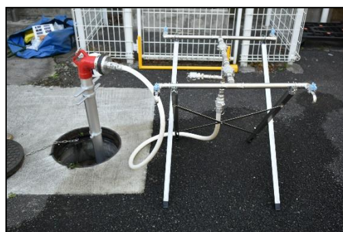
応急給水栓の確保
