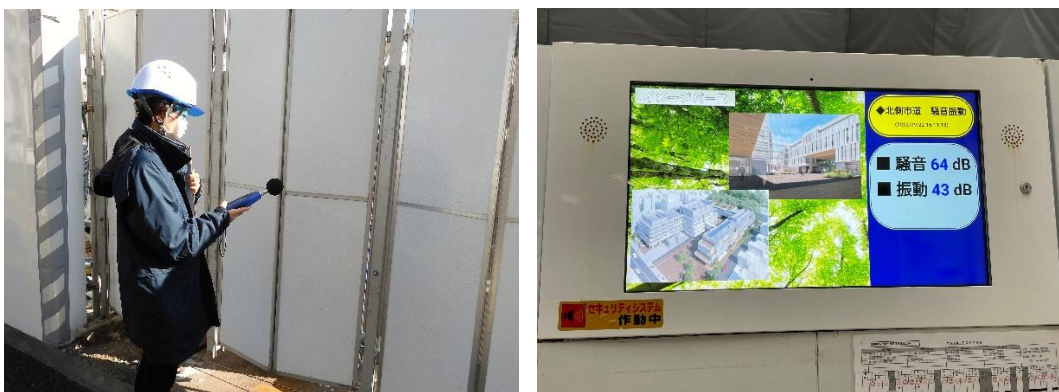
図 4.20 騒音調査の様子（左）と建設現場の騒音・振動レベルの電光掲示板（右）
