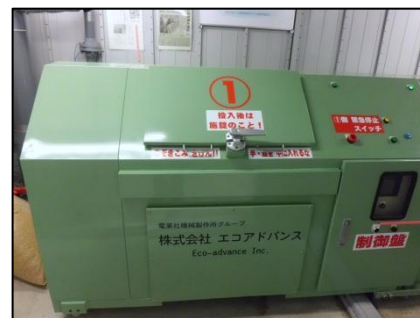
図 2-2-f 排出口・制御盤
