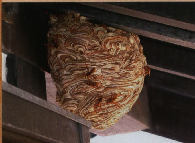
2階軒下にできたスズメバチの巣
