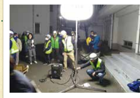
避難所(体育館)に整備された非常用発電装置を起動して照明を点灯させました。これにより避難所での作業効率が格段にアップしました。
