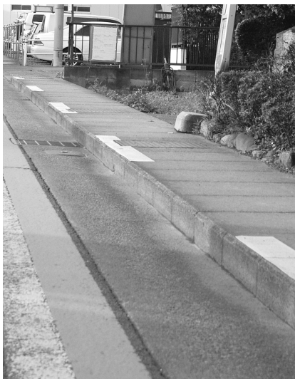
▲四谷通り歩道の段差
