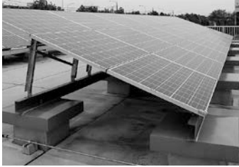
▲太陽光パネル
