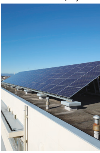
▲学校に設置している太陽光パネル
