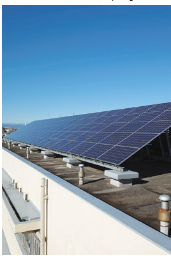
▲学校に設置している太陽光パネル
