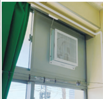
◀教室に設置された換気扇
