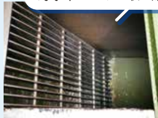
汚水中之ごみを取り除く設備
