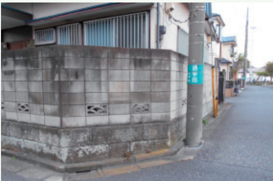
ブロック塀改修(施工前)
