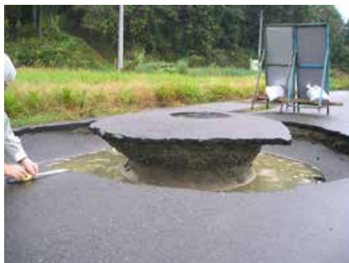
液状化によるマンホールの浮上
