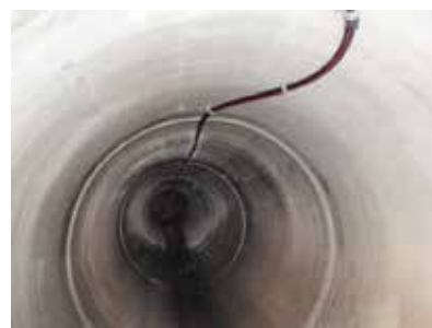
管きょ内に敷設された 光ファイバーケーブル
