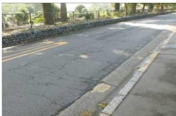
図 3-2-3-6 MCI=3 ひび割れが面状にひろがり、わだちが顕著
