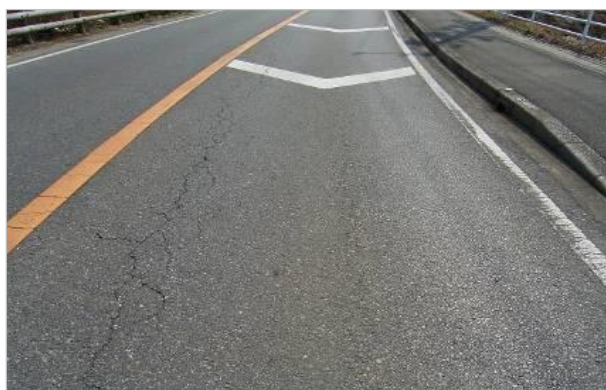
図 3-2-3-4 MCI=5 ひび割れが見える程度
