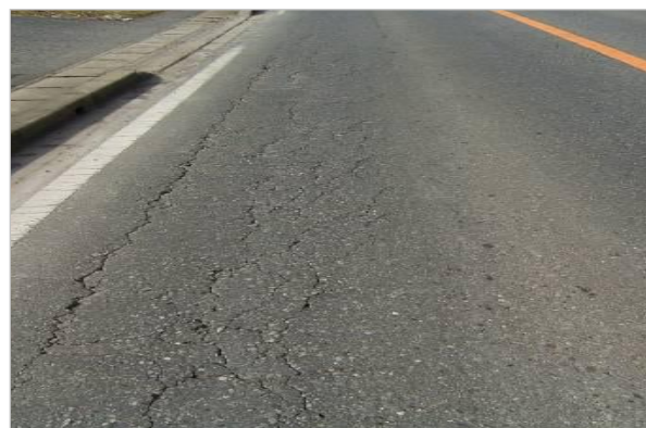
図 3-2-3-5 MCI=3.5~4 ひび割れが複数ある程度
