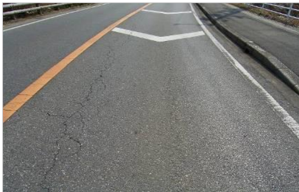
図 3-2-3-4 MCI=5 ひび割れが見える程度
