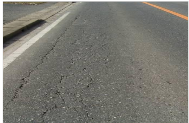
図 3-2-3-5 MCI=3.5~4 ひび割れが複数ある程度
