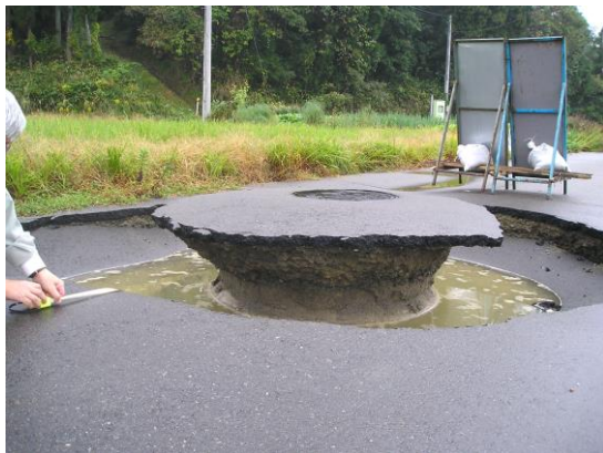
液状化によるマンホールの浮上
