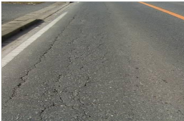
図 3-2-3-5 MCI＝3.5～4 ひび割れが複数ある程度
