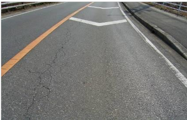
図 3-2-3-4 MCI＝5 ひび割れが見える程度
