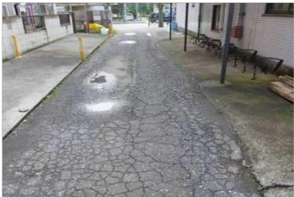
図 3-2-3-7 MCI＝2 ひび割れが全面にひろがり、わだち掘れが顕著
