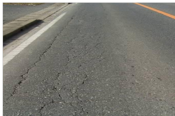
図 3-2-3-5 MCI=3.5~4 ひび割れが複数ある程度
