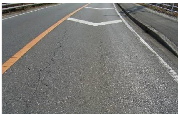
図 3-2-3-4 MCI=5 ひび割れが見える程度
