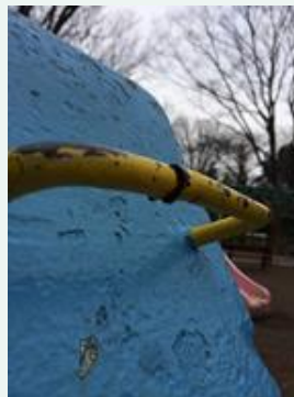
公園遊具の手摺が折れた事例
