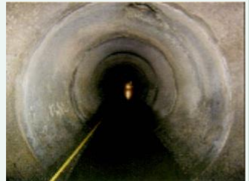
下水道管きよの老朽化の事例
