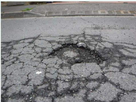
道路の舗装がひび割れ、穴が開いた事例
