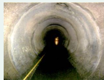
下水道管きよの老朽化の事例
