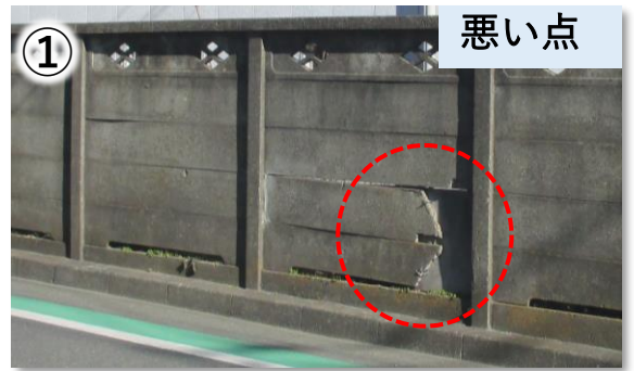
倒壊の危険性があるブロック塀
