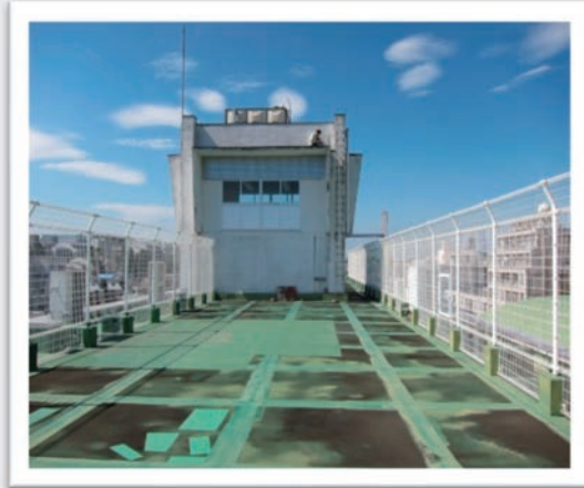
一中 屋上防水劣化状況
