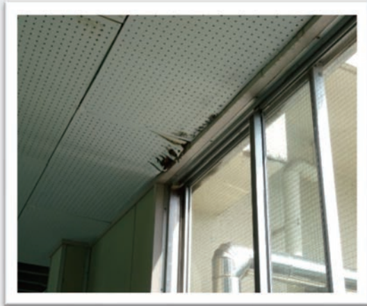
八小 内装劣化状況
