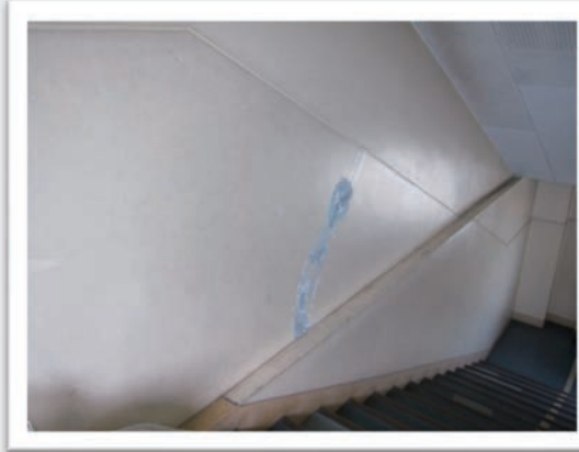
八小 壁のひび割れ
