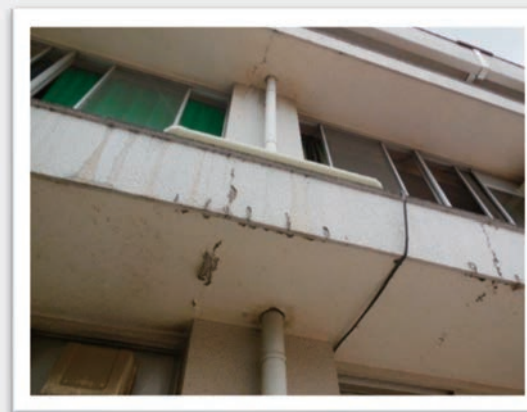
一中 外装劣化状況
