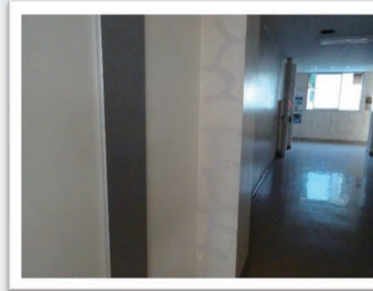
一中 柱のひび割れの状況
