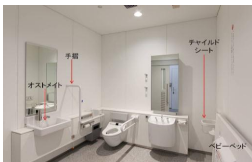
多目的トイレ(甲府市庁舎)
