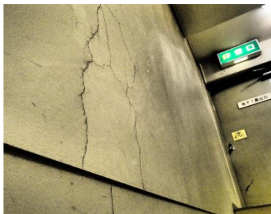
壁面のひび割れ
