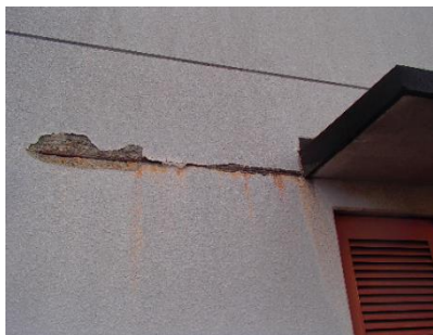
鉄筋の腐食による影響
