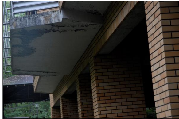
集会室のバルコニー 割れ・塗装の剥がれ
