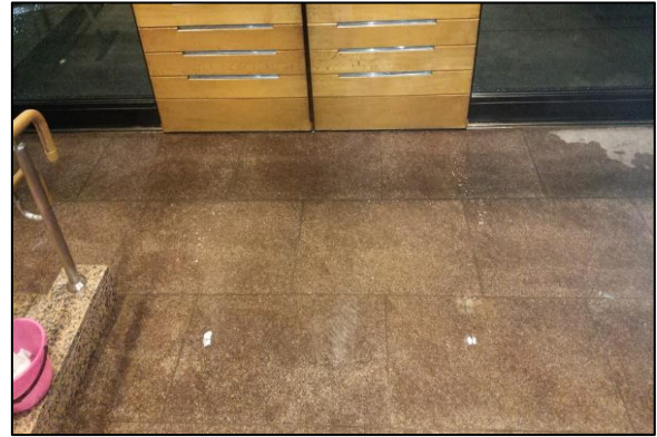
玄関部 隆起による玄関の浸水
