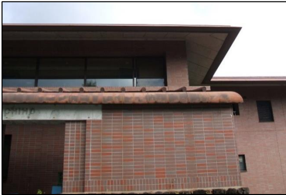
本館の屋根 経年による塗装の剥がれ
