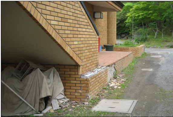
宿泊棟の外壁 タイルの剥がれ
