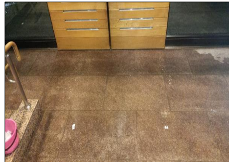
玄関部 隆起による玄関の浸水
