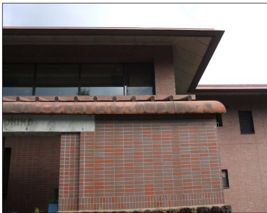
本館の屋根 経年による塗装の剥がれ
