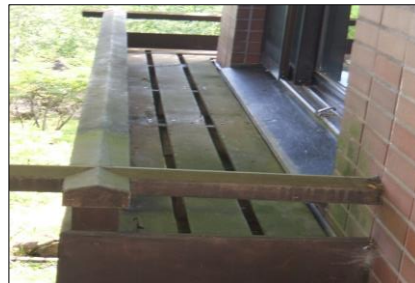
食堂のテラス 木部塗装のはく離
