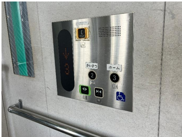
◎エレベーターの操作盤に浮彫文字や行先が分かりやすく表示されている。
