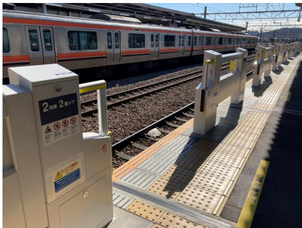
◎可動式ホーム柵が設置されている。
