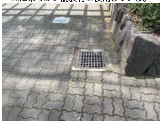
△視覚障害者が使用する白杖が入り込んでしまう水路蓋が使用されている。
