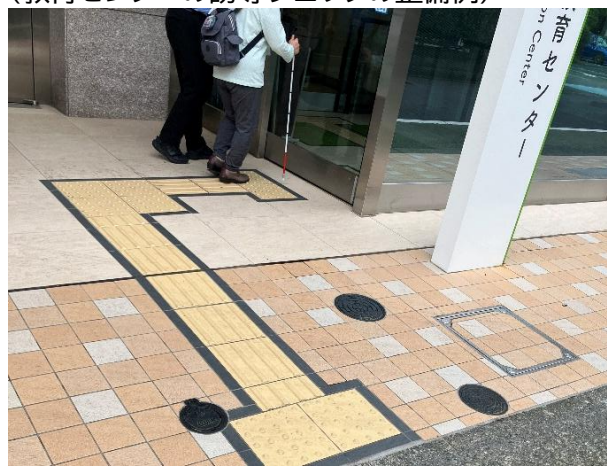
写真13 (教育センターの誘導ブロックの整備例)
