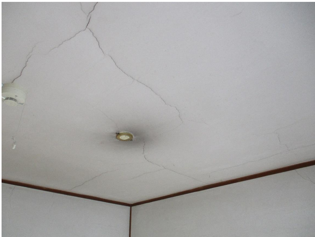
天井のひび割れ
