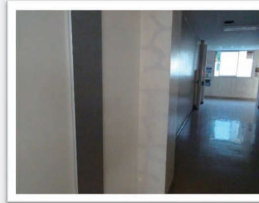
一中 柱のひび割れの状況
