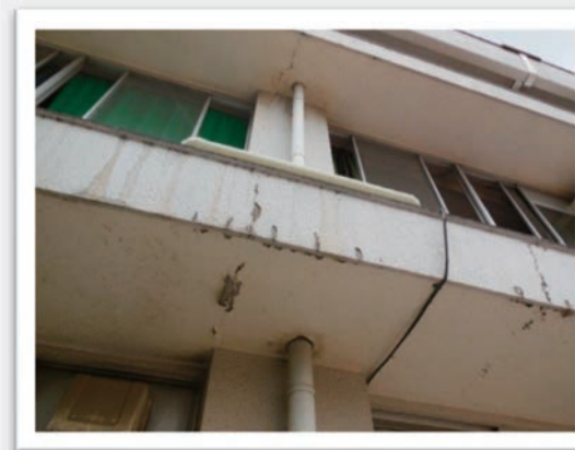
一中 外装劣化状況
