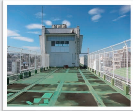
一中 屋上防水劣化状況
