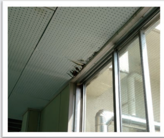
八小 内装劣化状況
