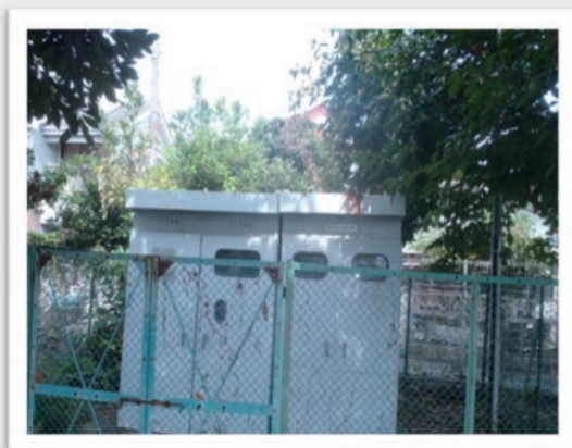
八小 設備劣化状況
