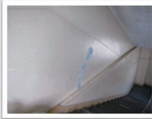
八小 壁のひび割れ
