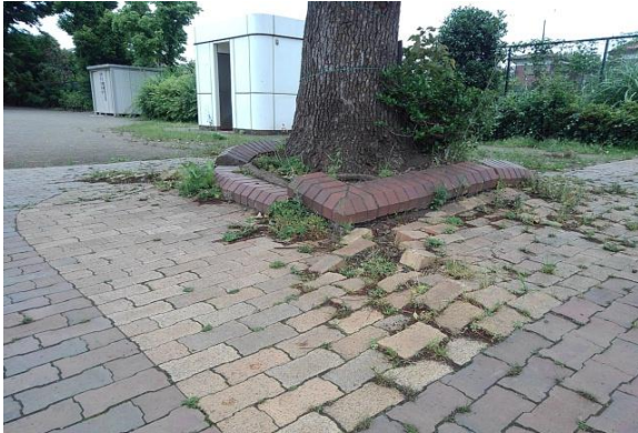
インターロッキングが木の根によって持ち上げられています
