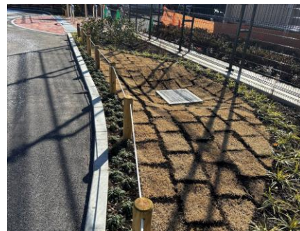
浸透マス（白糸台北公園、白糸台 1-50）
