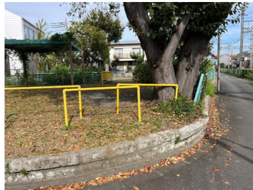
改修前の分梅第3公園の様子（分梅町 5-20） フェンスや石垣が崩れてしまいそうでした。
