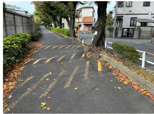
応急的な対応として、根上がり箇所の周りを緩やかにすることで、つまずき等の予防に努めています。
