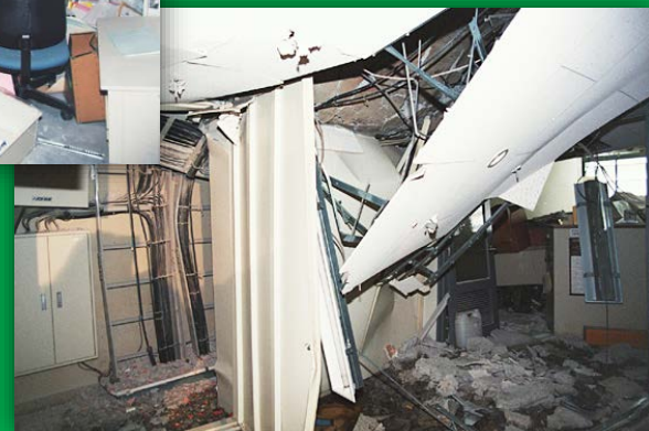
散乱した庁舎内
